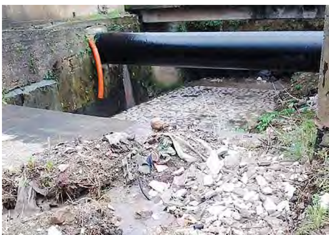
Un particolare della mega discarica abusiva vicino al cimitero
